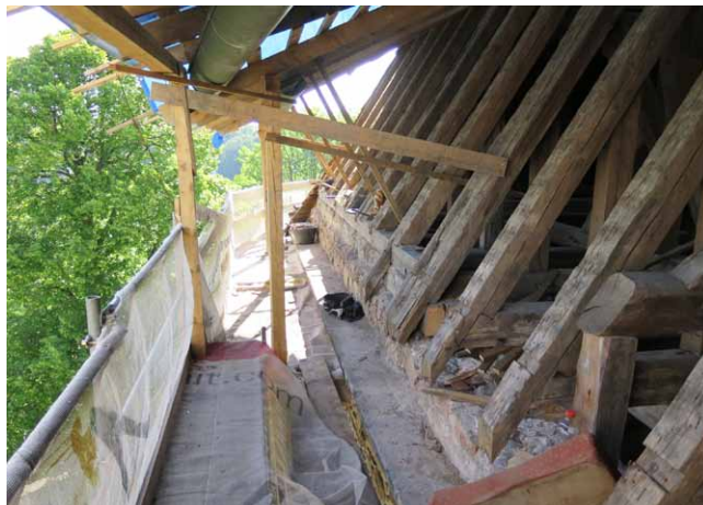
Nejv tší poškození krovu nad presbytář em je patrné na pozednicích a koncích vazných trámů a krokvi
