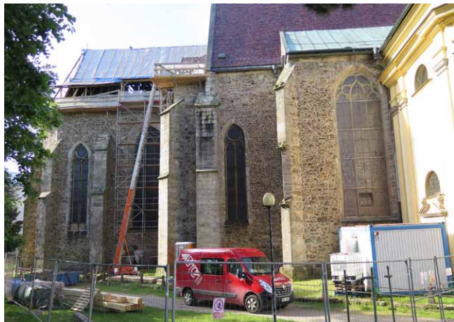
Opravným pracím p edcházelo vybudování stavenišť , instalace lešení a odsouhlasení typu a barev nové st ešní krytiny
