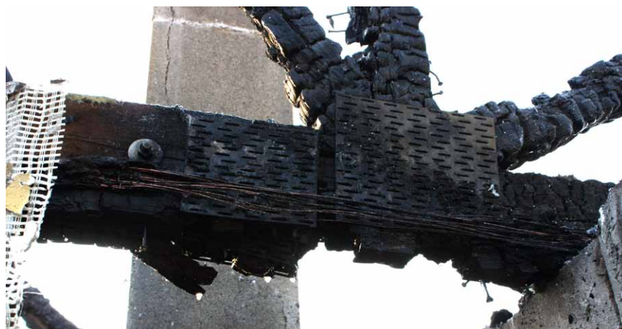
Detail poškození dvojice sbíjených vazníků procházejících nad obestavbou krbové vložky, z nichž vazník blíže ke komínu zcela shořel
