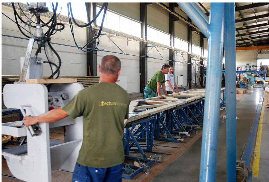
Priehradové väzníky spájajú styčnikovými ocelovými doskami s prelisovanými tržmi pomocou špeciálneho lisu (vľavo)
