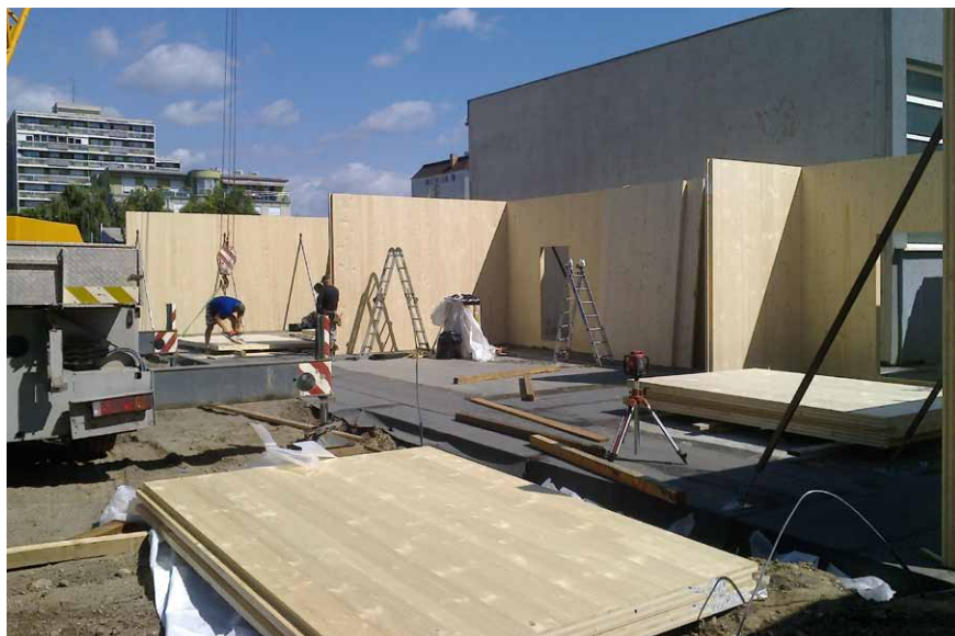
Na prístavbu šiestich tried 1. súkromného gymnázia v Bratislave na Bajkalskej ulici boli použité krížom lepené panely CLT
