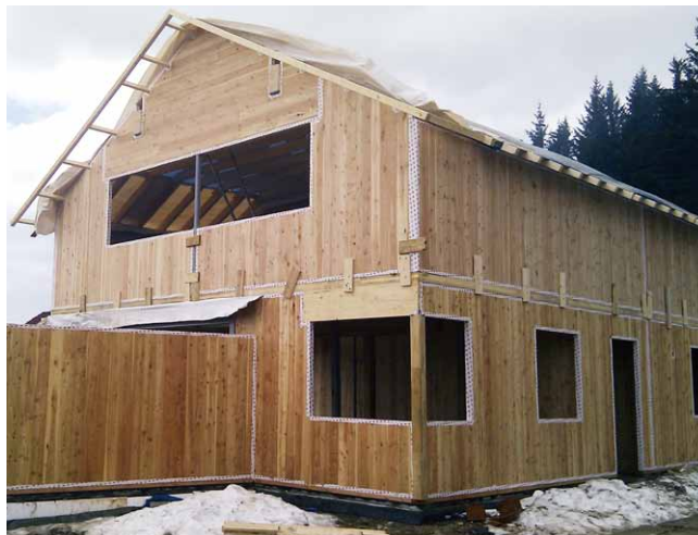
Na dokončenou nosnou konstrukci se aplikují různé skladby obvodových i vnitřních stěn
